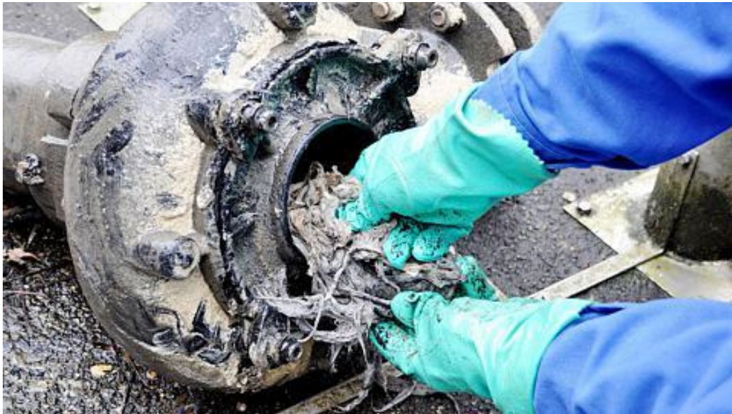
Bild: Verstopfung einer Schmutzwasserpumpe durch Feuchttücher
