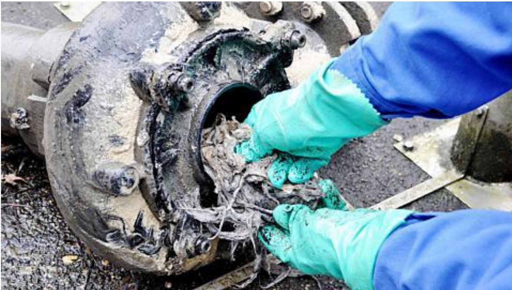
Bild: Verstopfung einer Schmutzwasserpumpe durch Feuchttücher
